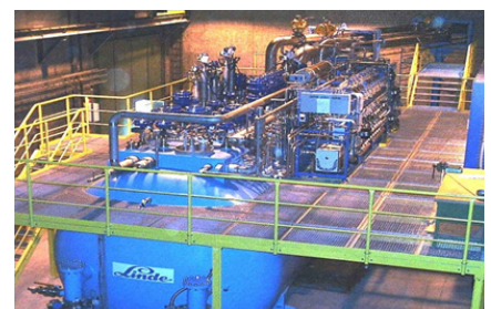
รูปที่ 5 อุปกรณ์ Cold Box ของ Linde เพื่อผลิตฮีเลียมเหลวให้กับเครื่องเร่งอนุภาค LHC
